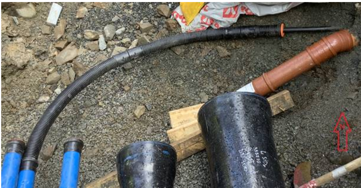
Figur 11: Påkoblingspunkt – stikkledning i varerør.
