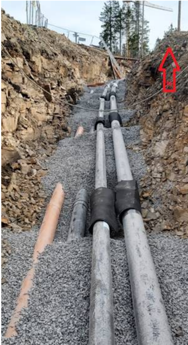
Figur 9: Bilde av ledninger mellom kummer.
