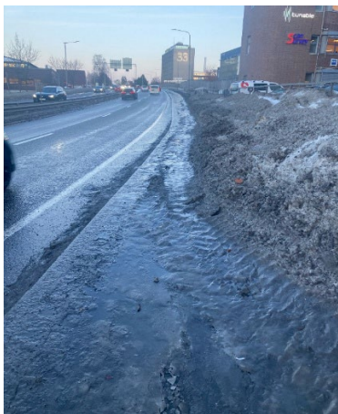
Mangelfull brøyting på gang- og sykkelveien langs Østre Aker vei. Fartsgrense er 80 km/t.
