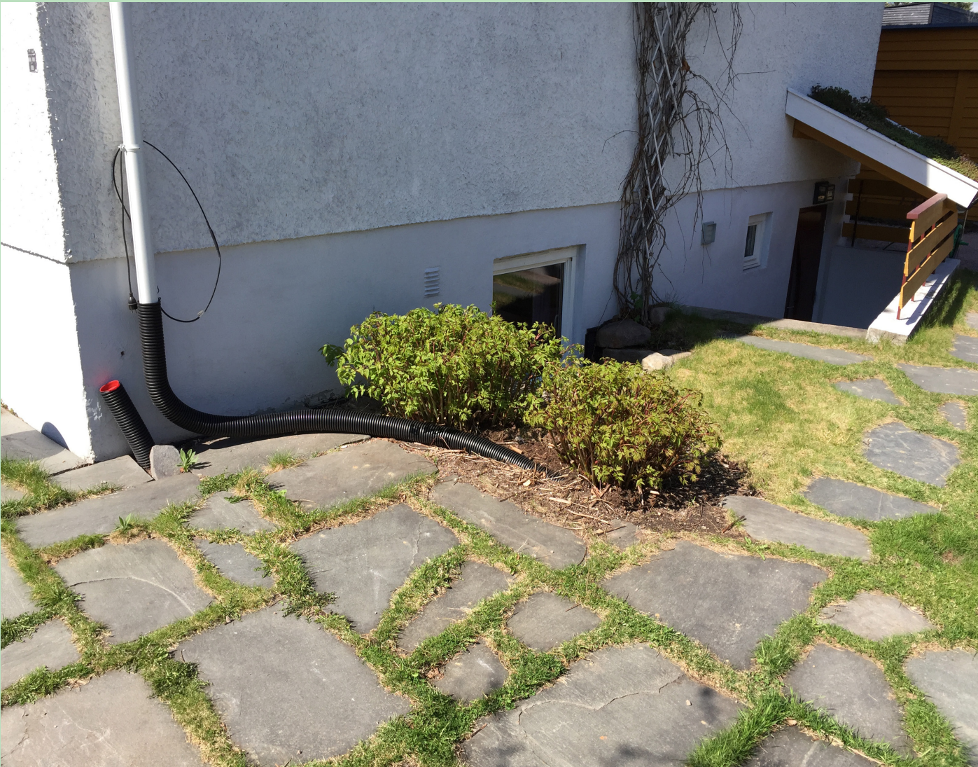
Taknedløpet ledes i rør ned i bakken og videre ut på plenen til høyre (Foto: Vann - og avløpsetaten)
