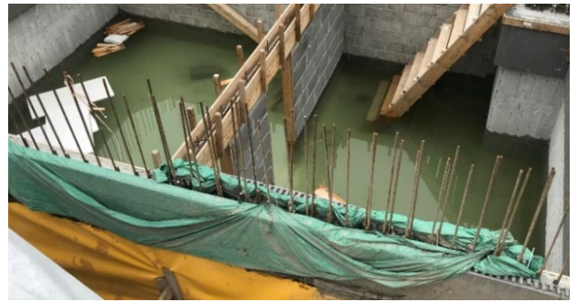
Figur 3: Her har utbygger gravd kjeller under grunnvannsnivå. Drensledningen blir da liggende i grunnvannet, og dette er ikke tillatt. For å unngå slike problemer, må grunnvannsnivået bestemmes i planleggingsfasen, slik at man kan bygge uten kjeller/med tett kjeller, jf. TEK 17 (Foto: Eyvind Andersen)
