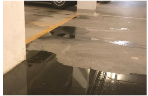
Figur 6: Fukt i garasjeanlegg skal ikke føres til VAVs ledninger, men må håndteres lokalt. VAV tillater ikke etablering av sluk med oljeutskiller i garasjeanlegg (Foto: Eyvind Andersen)
