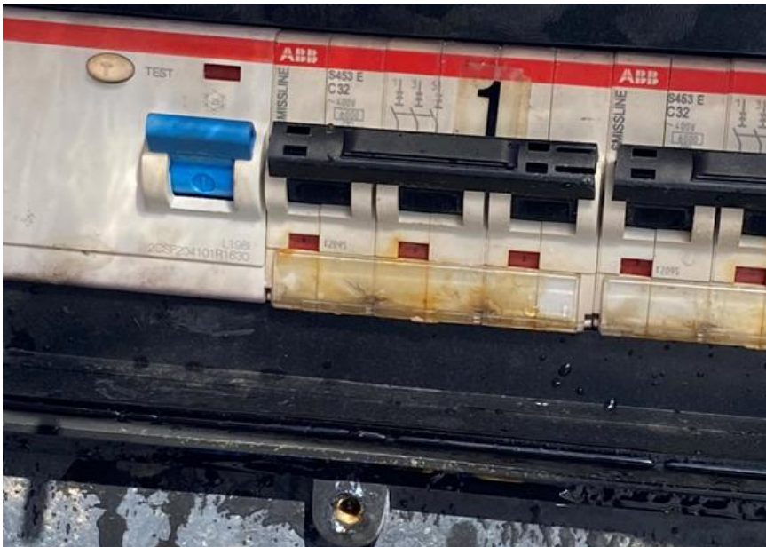
Figur 11 – Varmgang i vern.
