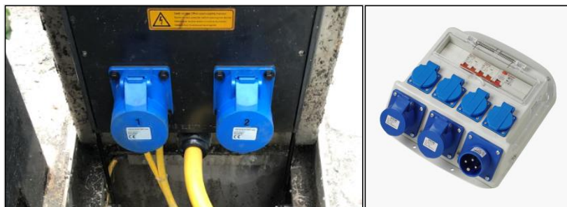
Figur 2: TV: Eksempel på 3-faset 32A uttak på Stortorvet. TH: Eksempel på byggsentral tilpasset uttak.
