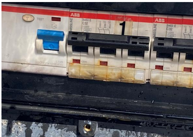
Figur 11 – Varmgang i vern.
