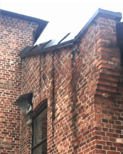
Fuktstriper på mur tyder på utette beslag
