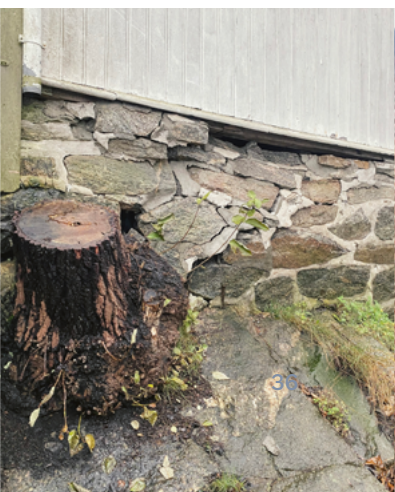
Røtter liker seg i fuktige sprekker og kan sprengne mur
