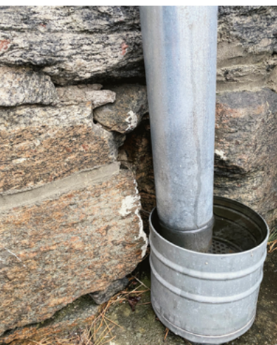
Nedløpsvann i "sluk" med rist.
