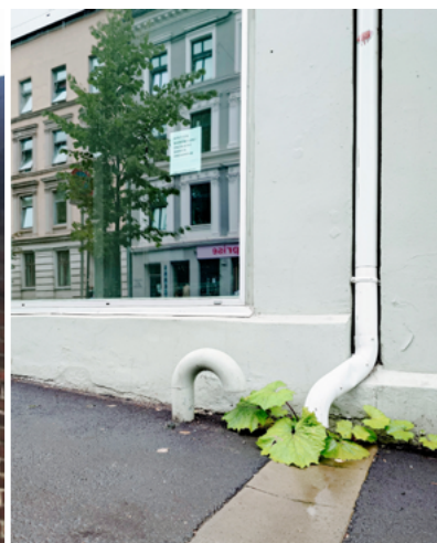
Ivrig vegetasjon på steder med jevn fuktighet
