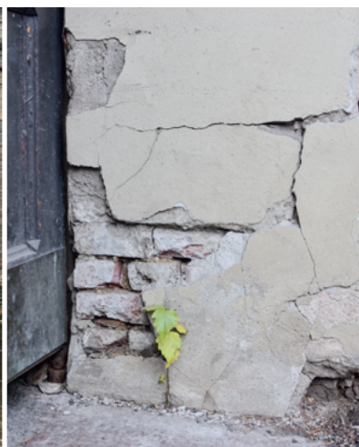
Fukt gir skader på puss, utvasking av fuger og frostsprengte murstein
