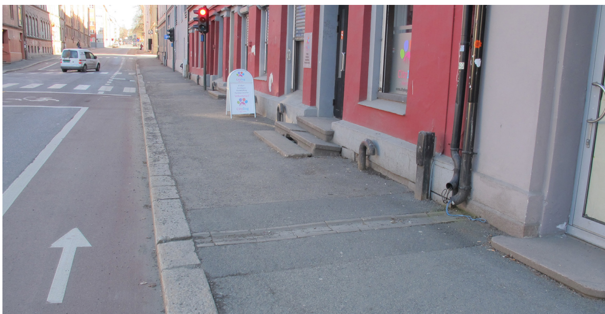
Figur 17: Bildet viser renne for bortledning av vann fra taknedløp. Disse rennene er ikke utformet i henhold til dagens krav om universell utforming.
