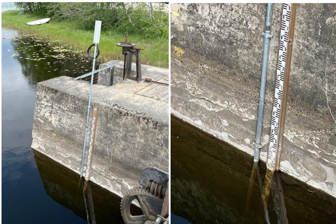
Figur 3-6: Vannstanden i Verkensvann på befaringsdagen. Gult merke i betongen viser normalvannstand før senkning i 2022. Vannstand på befaringsdagen var kote 182.18. Foto: Rune Moe
