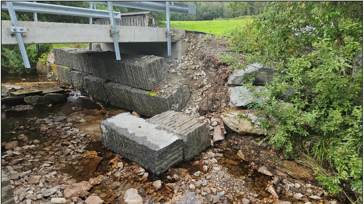
Figur 3-12. Utsklidning av brufundament i bekk 2023 etter flommen hans.
