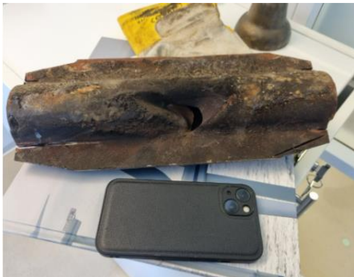
Figur 24 Eksplosjoner på Haraldrud energianlegg (HEA) Bildet viser del av et kjelrør som ble punktert av en eksploderende lystgassbeholder. Skjer også eksplosjoner i askeutmatning mm.
