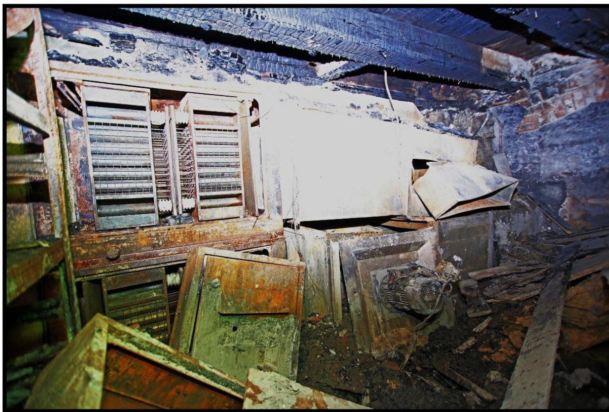
Bilde 8: Bilde tatt i rommet der ESP-filteret i kjøkkenventilasjonen var plassert i kjeller. Servicelukene til filteret har falt av under brannen. Det er kraftige innbrenninger i bjelkelaget da det tok lang tid å få slokket brannen.
