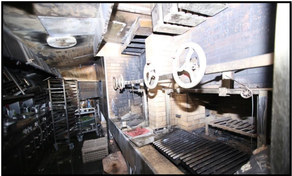
Bilde 1: Foto av grillene er tatt under brannevaluering. Det var kun grillen til høyre som var i bruk når brannen oppsto. Det er felles avtrekkssystem over de to grillene.
