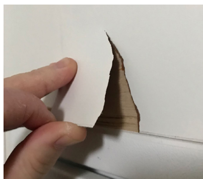
Eksempelbilde på at baderomsplater kan være et sårbart materiale. Ved slik ødeleggelse, er ulempen at hele platen bør byttes for å reparere skaden.
