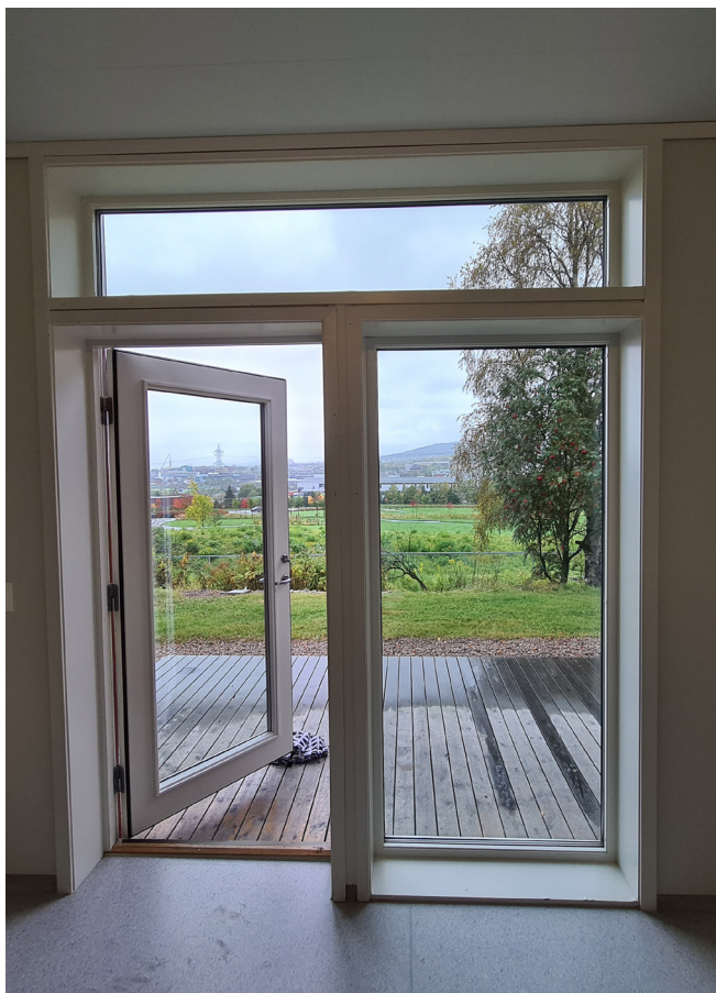
Eksempel på glassfasade som bør unngås. Her er inngangsdør eneste mulighet for å gi frisk luft til leiligheten, samt at glassareal går helt ned til gulv, som ikke er å anbefale for beboergruppen. Glassareal under 80 cm inngår uansett ikke i dagslysberegning iht TEK17.
