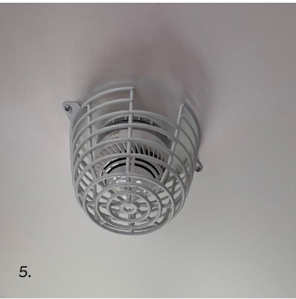
5. Detektor - montert i himling, med beskyttelsegitter Ikke anbefalt
