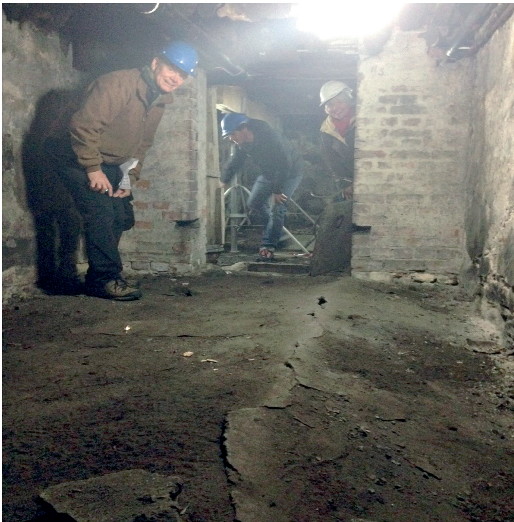
Undergrunnsprosjektet på befaring for å se på setningskader i kjelleren på Youngs gate 7 før renoveringen i 2017 og 2018 (Foto Ingelöv Eriksson/PBE)
