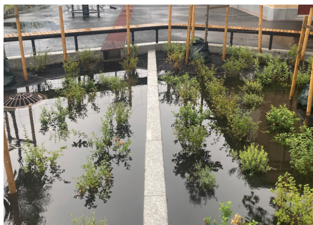
Bilde 1: Fordrøyning av overvann i vegetasjonsarealer
