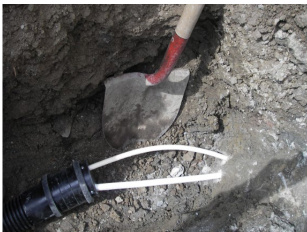
I NB21 er drencrøret avsnørt for å utnytte volumet i filteret og å redusere belastningen på kommunalt nett.
