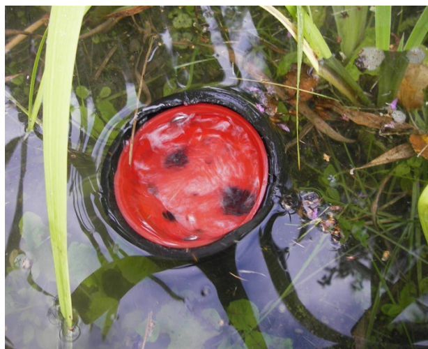
Overvann renner inn i drencrøråpningen i NB21 når overflatevolumet er fylt.
