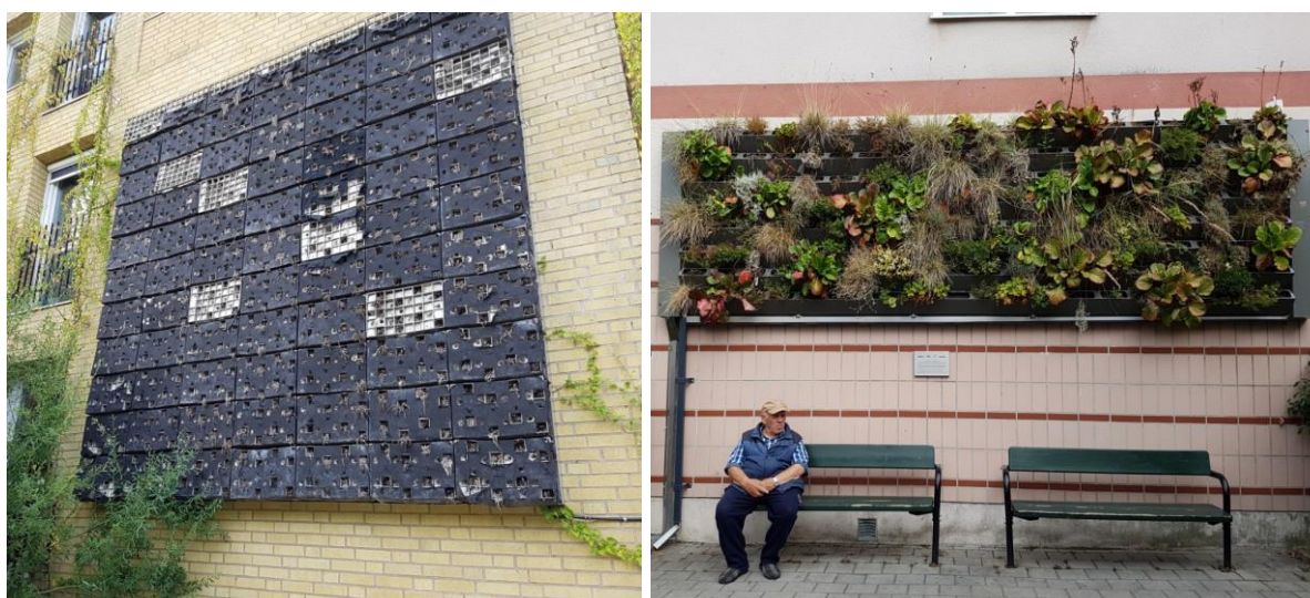
Figur 71. Mislykket og vellykket grønn vegg. Det var ikke mulig å skifte ut døde planter i den mislykkede veggen uten at vekstmediet den stod i ble ødelagt. Tilrettelegging for enkel drift er nødvendig.
