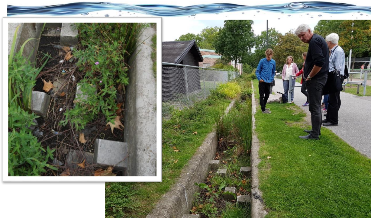
Figur 76. Kanal med betongterninger i 3 høyder, hvorav den nederste allerede er tett av sedimenter. Meget vanskelig å vedlikeholde/fjerne sediment. Kanskje sedimentet er ønskelig; på sikt kan kanalen bli en vannvei med vegetasjon. I så fall er vedlikeholdet ubetydelig og miljøeffekten trolig betydelig?
