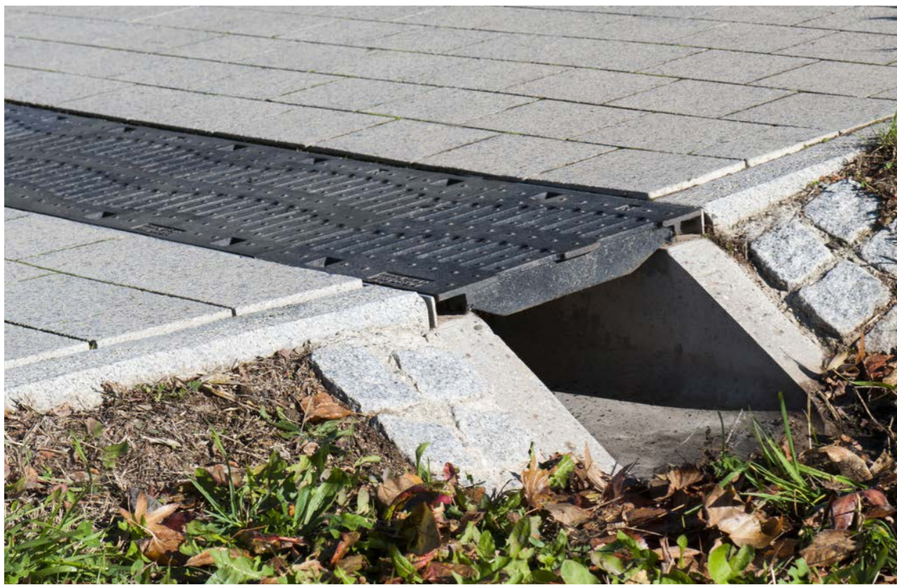
Bilde 4.9: Skybruddsrenne (Foto: Rambøll)
