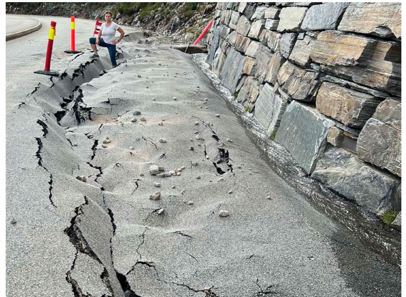
Bilde 5.20: Lokal vei i Burud i Drammen kommune som ble ødelagt etter styrtregn (foto: Cathrina de Lange) | Bilde 5.21: Erosjon av vei i Sandnes (Foto: Inger Anita Merkesdal)
