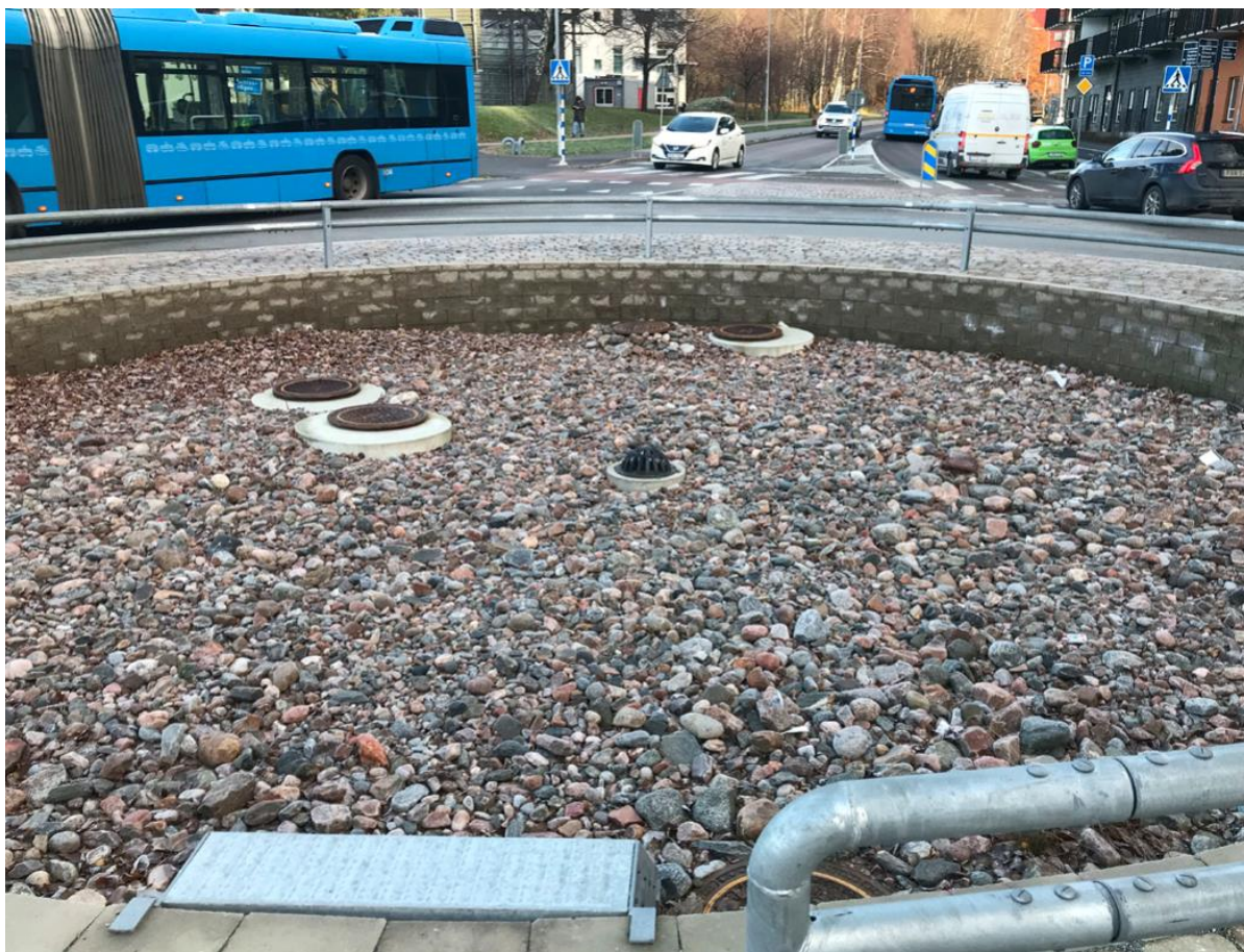
Figur 28: Fordrøyning i rundkjøring i Smørslottsgatan, Gøteborg (Foto: Rambøll).
