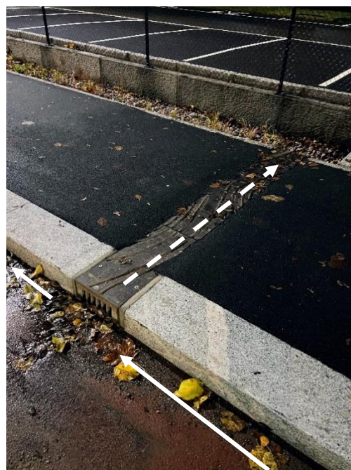
Figur 40: Kjeftsluk og renne som inntak til regnbed i Uelandsgate, Oslo (Foto: Sigmund Wiig Petersen, Rambøll).
