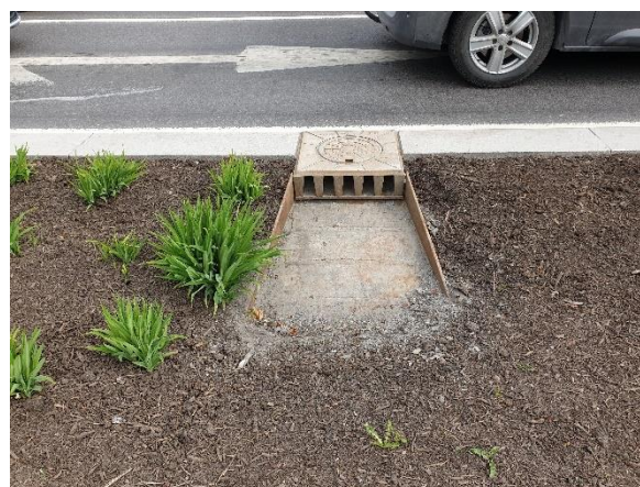
Figur 46: Kjeftsluk som innløpsanordning for overvannet inn i regnbedet (Foto: Rune Bratlie).
