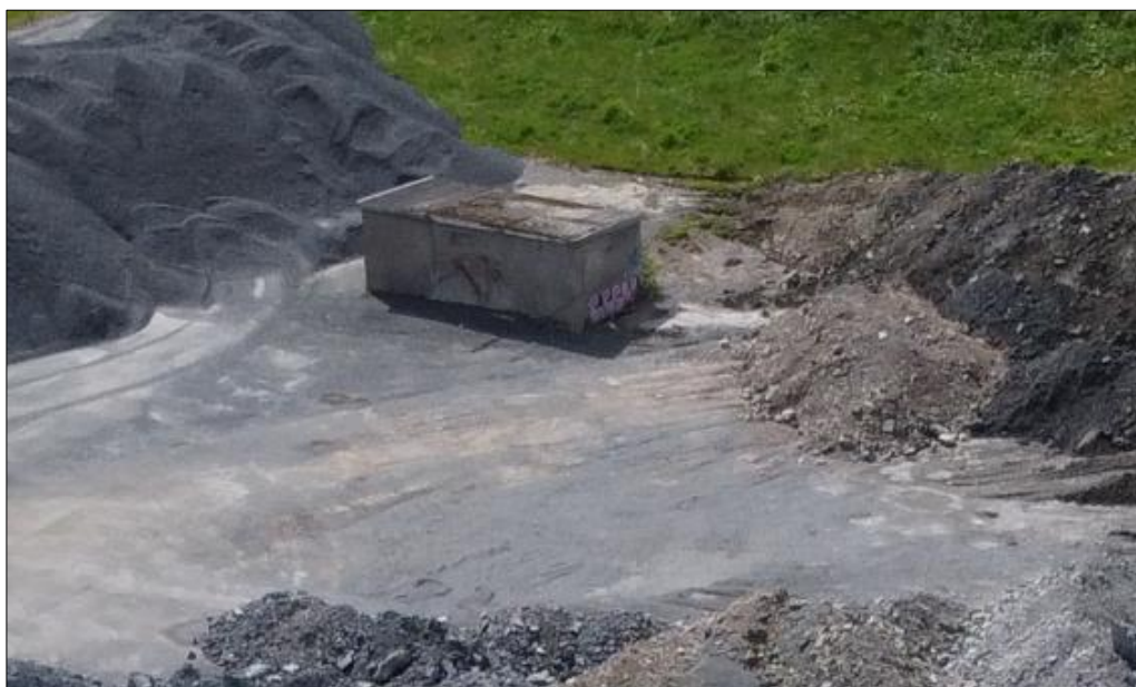
Figur 3-5. Dronebilde fra 2022 som viser eksisterende trafo 3037. Kilde: Multiconsult.
