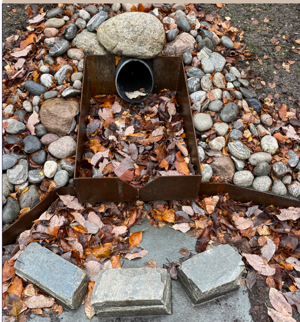
Figur 7. Velfungerende slamfeller: Vannet strømmer inn i en metallboks med slisse og V-overløp. Slissa sørger for at slamfella ikke har stående vann (med mulige myggproblemer), og bremser og fanger sedimenter og søppel. V-overløpet sørger for å styre vannet til rett sted i regnbedet. Slamfellene har metallgolv, noe som letter fjerningen av sedimenter og søppel.
