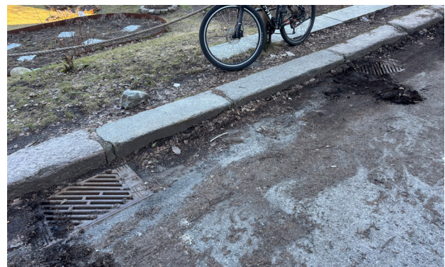
Figur 9. Venstre sluk fører vann til regnbedet og ligger oppstrøms sluket til høyre. Venstre sluk blendes i «salt-sesongen», i dette tilfellet med en oppblåsbar pølse i røret.
