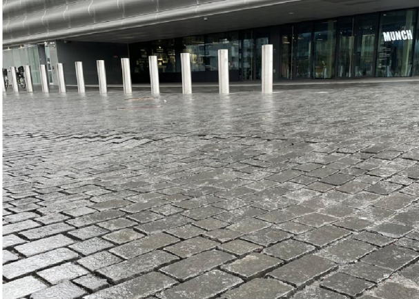
Figur 19 Brosteinsdekke foran MUNCH, med setning på tvers av gangretningen
