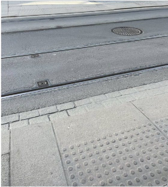
Figur 25 Nedsenk i fortau i Prinsens gate
