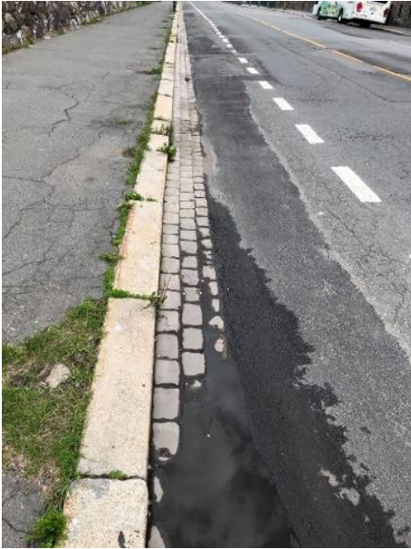
Foto 9: Ujevnheter i asfalten i Kongens gate ved Nasjonalmuseet for arkitektur. Bildet er tatt 27. mai 2021.
