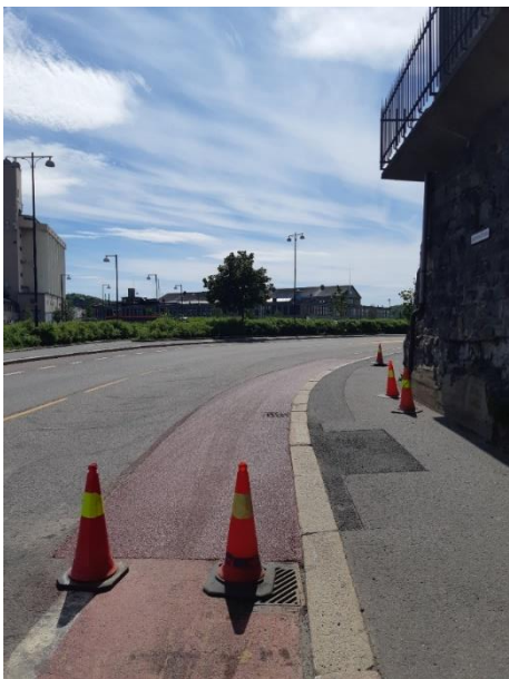
Foto 10: Reparasjon av sykkelfelt. Bildet viser at det nye sykkelfeltet er noe bredere enn det opprinnelige. Bildet er tatt 16. juni 2021.
