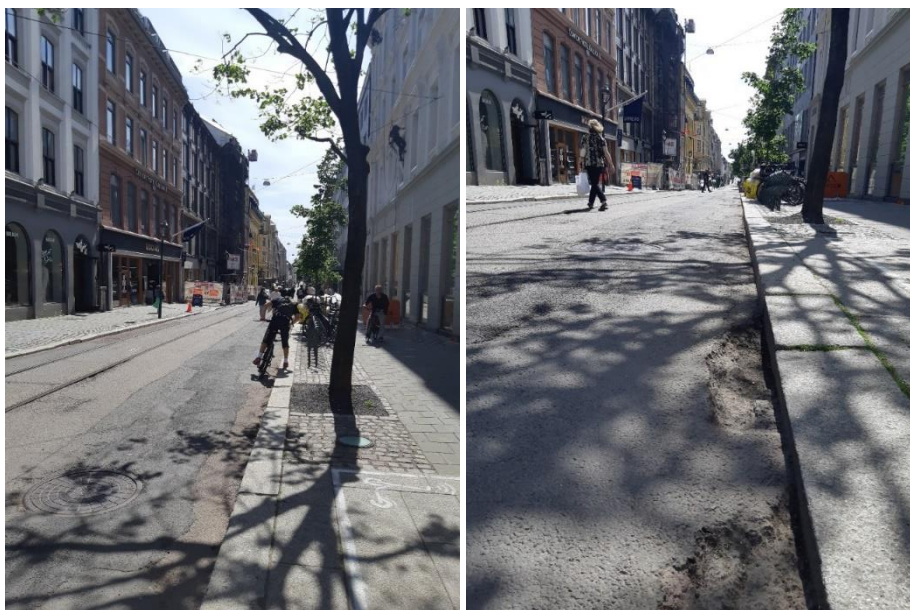
Foto 7: Falmet og lappet rød asfalt i krysset Karl Johans gate og Kirkegata. Foto 8: Hull i asfalten, like etter kryssing av Karl Johans gate. Bildene er tatt 16. juni.
