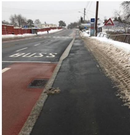
Bilde 1 Bar asfalt, Skullerudveien 05.02.2019
