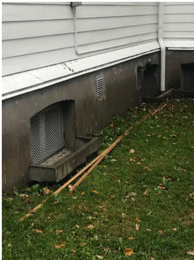
Svært fuktige forhold rundt villaen, kan være et resultat av tette taknedløp. Det ble også observert at flere av taknedløpene ledet vannet rett i bakken, uten å lede dette vekk fra grunnmuren. Foto: Lala Tøyen
