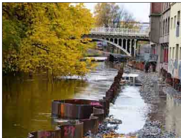
Flom i Akerselva, oktober 2012. Arbeidet med Midtgardsormen er godt i gang Foto: Vann- og avløpsetaten
