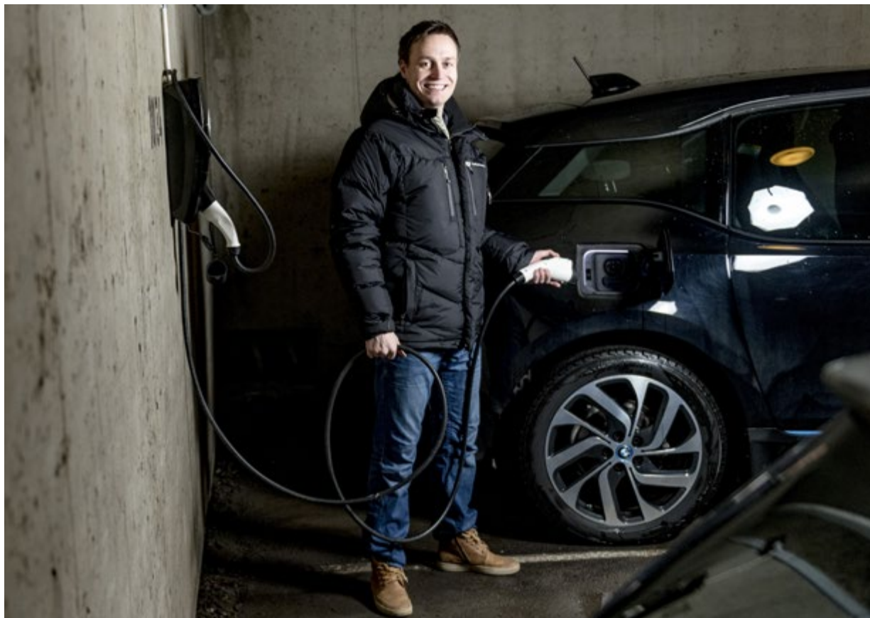
Nordseterskogen borettslag på Ekeberg har tilrettelagt alle sine 108 parkeringsplasser for elbillading. Styreleder Fredrik Ness Engh sier tilskuddet fra klima- og energi-programmet var avgjørende for økonomien i prosjektet. Foto: Fartein Rudjord
