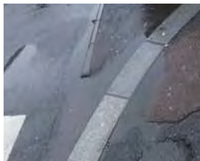
Kantstenene forsvinner når kun asfaltdekket utbedres. Torggata/Youngsgata.
