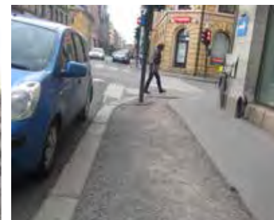
Asfalten på fortauene holder ikke mål og på flere steder er det gjennomført for dårlig "lappearbeid". Tollbugata/Skippergata.
