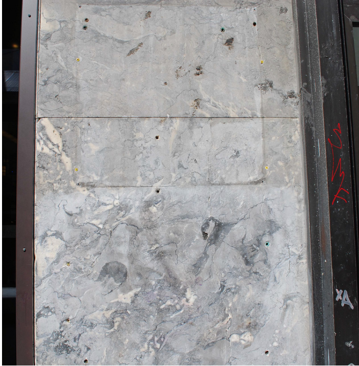
Folketeaterbygningen (1935), fasaden mot Storgata. Bekledningssteinen bærer tydelig preg av tidligere skilting utenfor den etablerte skiltflaten. Enkelte plater har også sprukket. Materialet er en lys Porsgrunnsmarmor som vil være svært vanskelig å erstatte eller utbedre.
