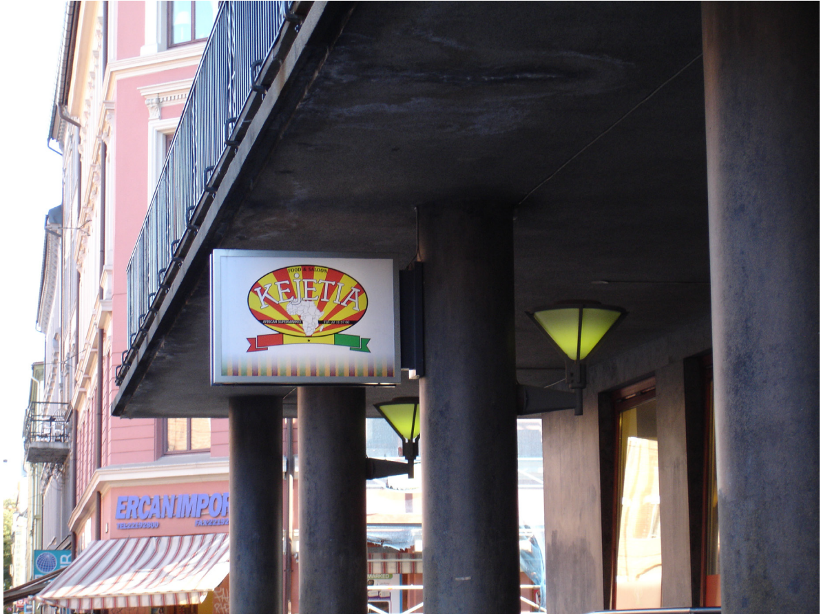
Trondheimsveien 5, tidligere Aker herredshus. Svært uheldig plassert uthengskilt som foruten å svekke fasademotivet også vil etterlate skjemmende sår i granittsøylen. Skader i slike elementer må utbedres av en kvalifisert steinkonservator for å oppnå tilfredsstillende resultat.
