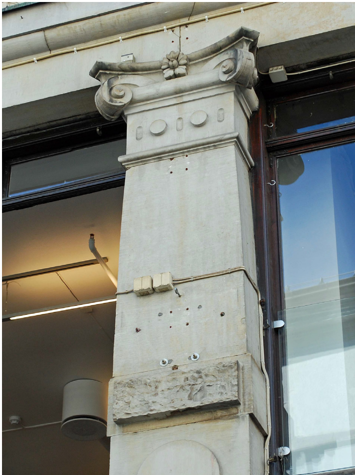
Nedre Slottsgate 15. Pilastrene er skjemmet av hull og elektriske installasjoner.
