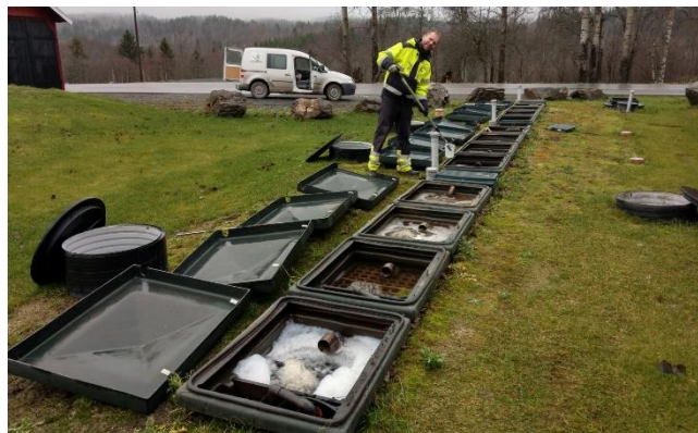
Figur 10: Tilsyn med avløpsanlegg i spredt bebyggelse gjennomføres jevnlig. Bildet viser et stort anlegg (Foto: VAV).
