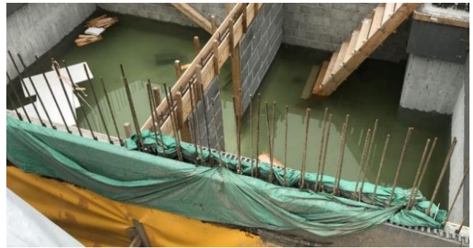
Figur 3: Her har utbygger gravd kjeller under grunnvannsnivået. Drensledningen blir da liggende i grunnvannet, og dette er ikke tillatt. For å unngå slike problemer, må grunnvannsnivået bestemmes i planleggingsfasen, slik at du kan bygge uten kjeller eller med tett kjeller, jf. TEK 17 (Foto: Eyvind Andersen)
