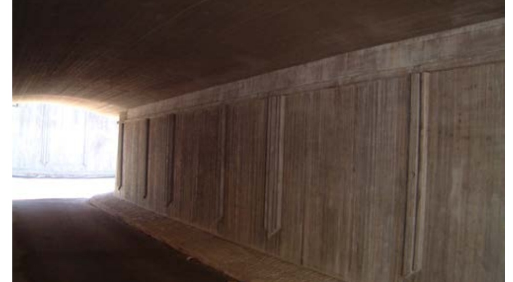
Kombinasjon av belysning og relief på kulvert veggen i Billingstadsletta skaper variasjon.
