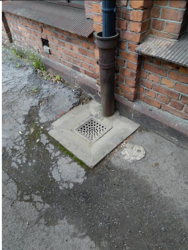
217: Nedløp og drenskum, fasade vest 6
