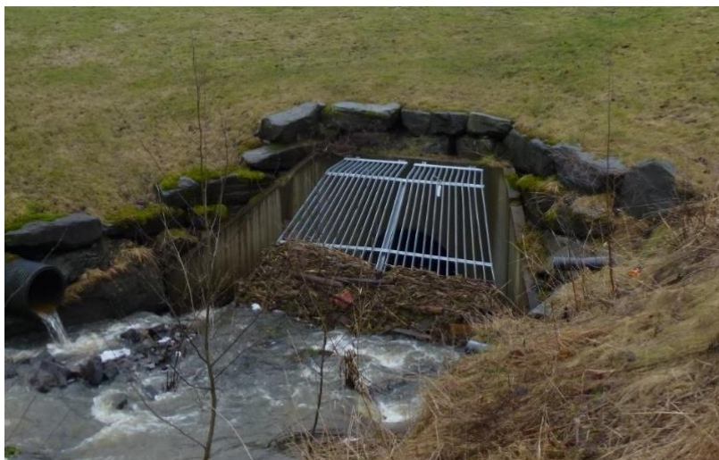
Figur 3-3. Eksempel på tilstoppet rist ved vingemur.
