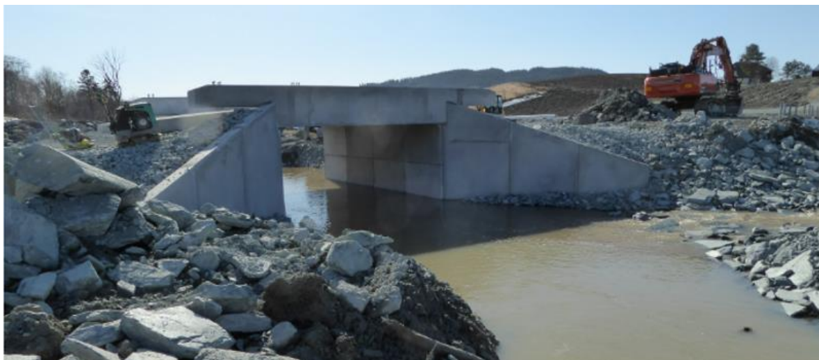
Figur 8-6. Eksempel på kulvert.
