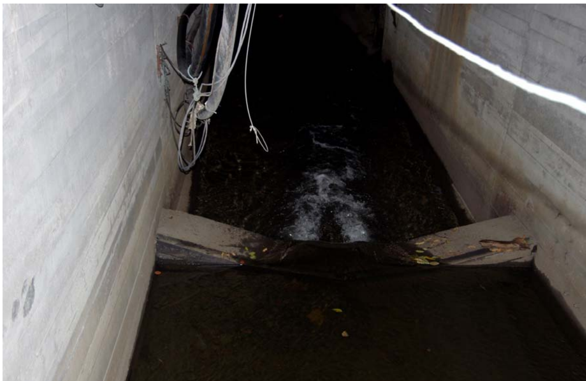
Bildet viser måleprofilen i Frogrnerelva målestasjon som ligger i en fjellttunnel.
